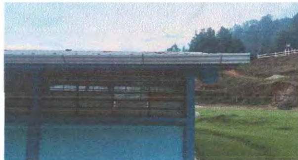
Foto 2: cambio de vidrios, por falta de buena seguridad
